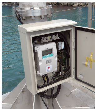
変換器設置状況
