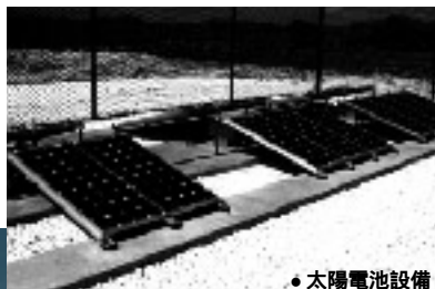
● 太陽電池設備
